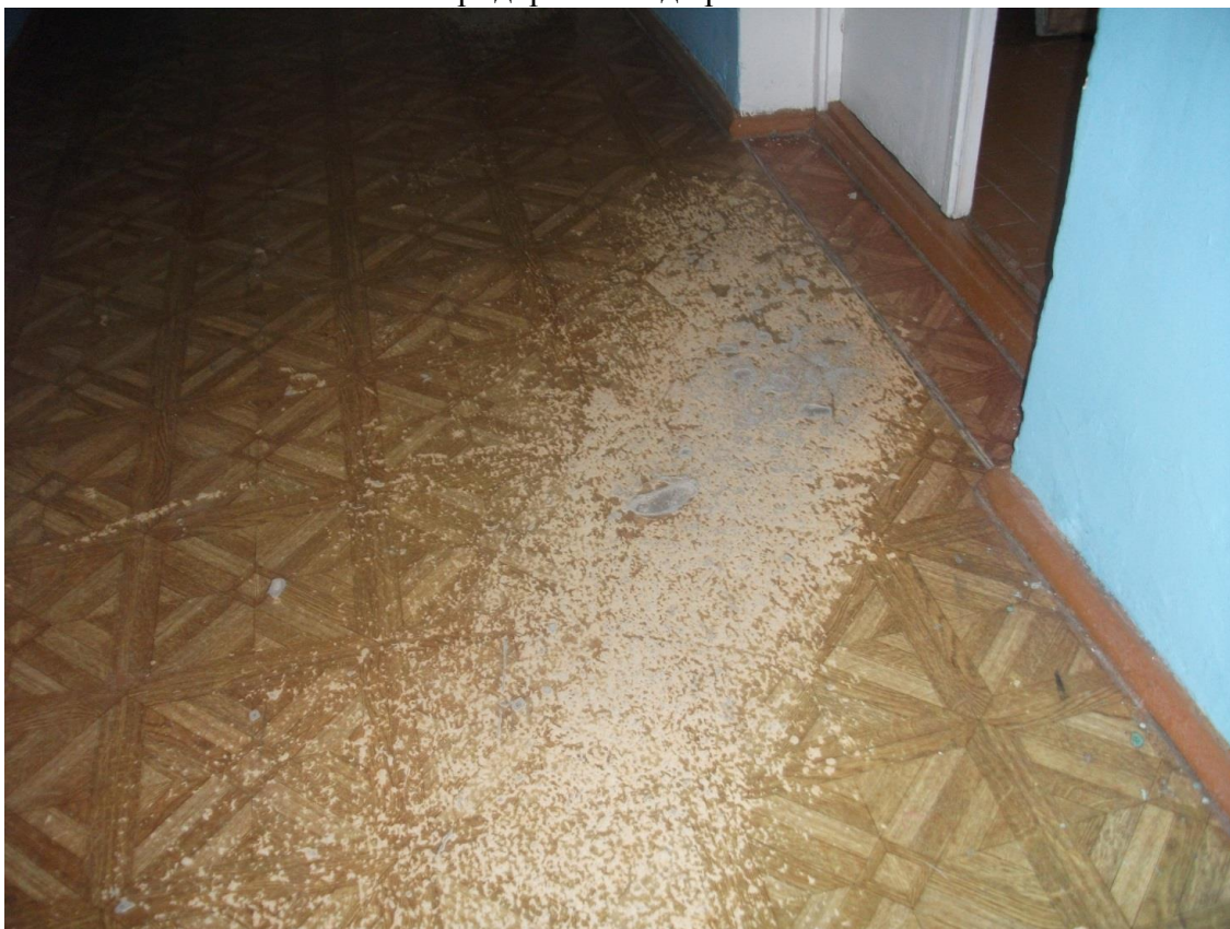
Коридор 2 этаж до ремонта
