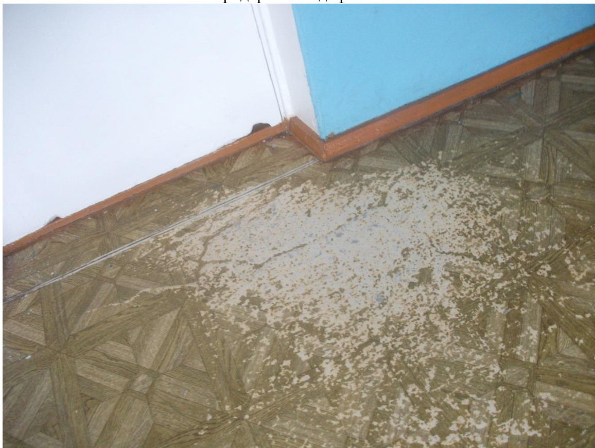
Коридор 1 этаж до ремонта
